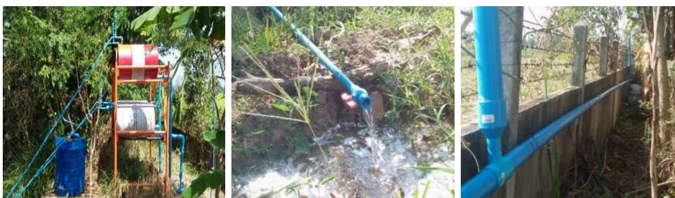
ภาพที่ 4 เครื่องกระจายน้ำประหยัดพลังงานเสร็จสมบูรณ์ และการทดลองใช้ระบบจริง
