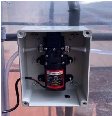
ก) ควบคุมปั้มน้ำสำหรับระบบหัวพ่นหมอก
